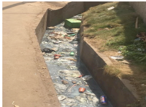
Photo 8: Un caniveau obstrué par les ordures au quartier Habitat
