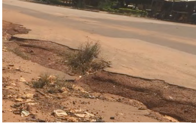
Photo 6: Une voie bitumée dégradée au quartier Assabou
