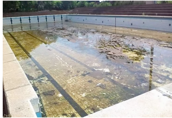
Photo 4: L'état de dégradation de la piscine du lycée scientifique de la ville
