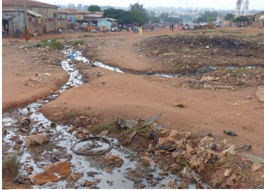
Photo 5: Etat de dégradation d'une voie en terre au quartier Morofé
